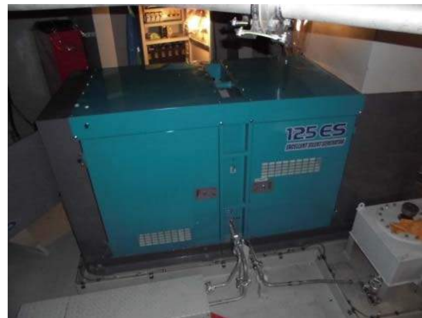
バックアップ発電機
