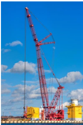
小名浜港に入港している7MW風車搭載用浮体と組み立て中のクレーン
